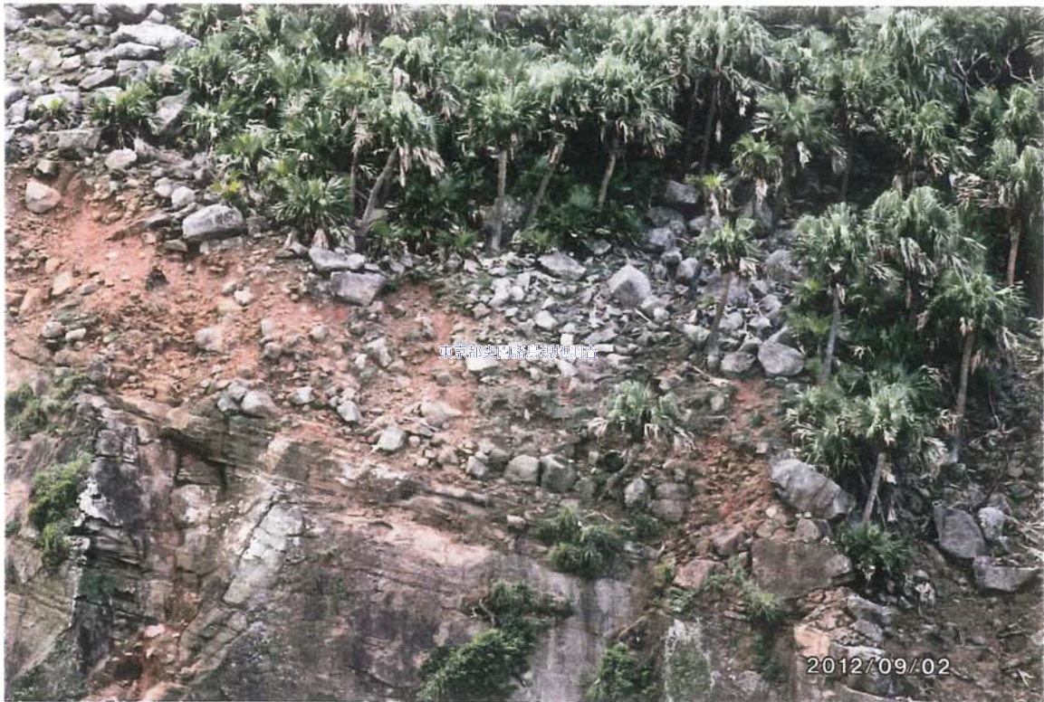
写真 27 魚釣島、写真 26 のさらに右側の崖上緩斜面。崖際の土砂の流失が著しい。
